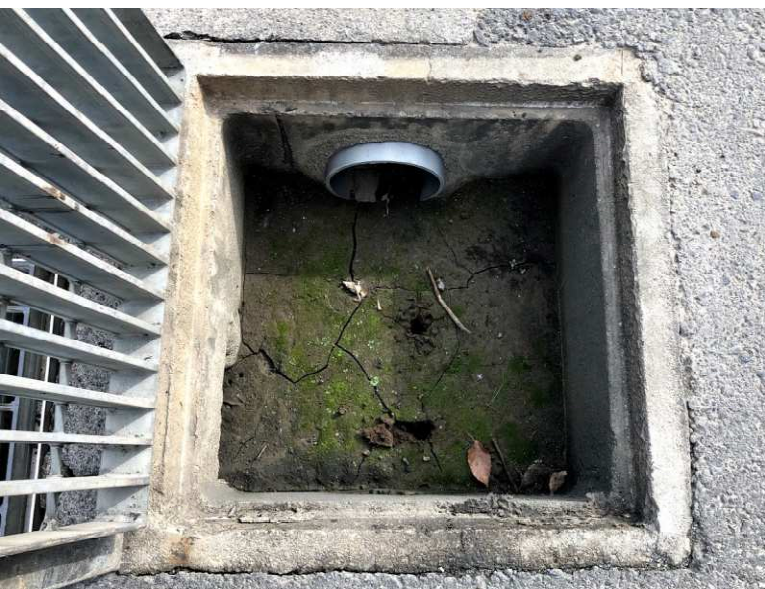
b. 泥溜まりスペース堆積あり
