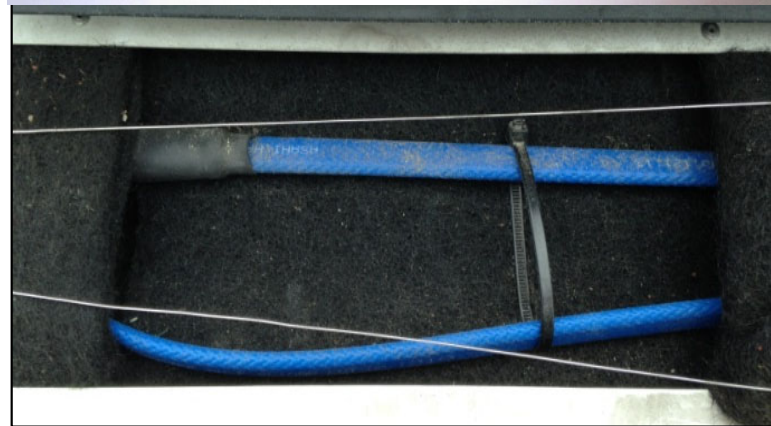
↑分別集水マットの構成 ←樋ヒーターの敷設位置
