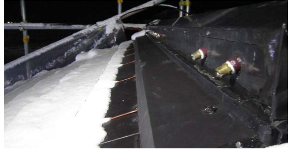
②棟ヒーター、水切りヒーターON
