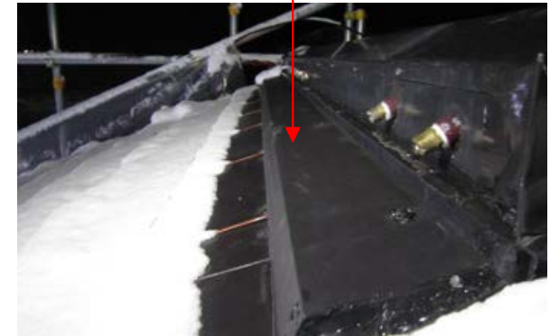
着雪前 棟、水切りヒーターON
