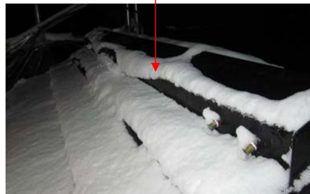
着雪後 棟ヒーターON
